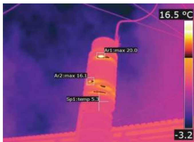
Рис.3. Термограмма конденсатора связи воздушной линии электропередачи напряжением 110 кВ.
