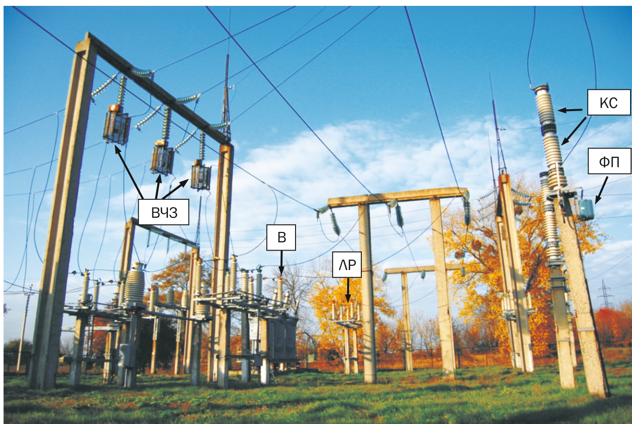
Элементы высокочастотного канала на линии электропередачи
