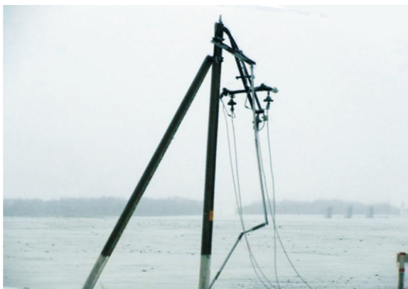
Обрыв проводов и разрушение опоры
