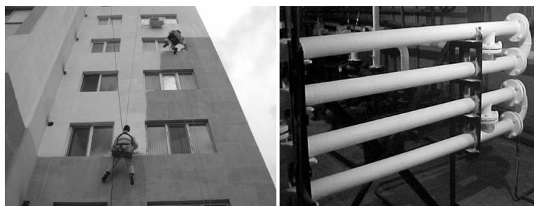
Рис. 1. Примеры утепления фасада здания и инженерного оборудования термокраской
