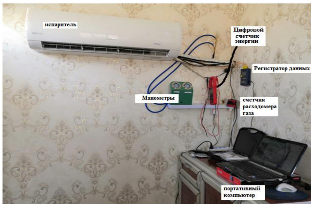
Рис. 3.5. Фотография кондиционируемого помещения с внутренним блоком
