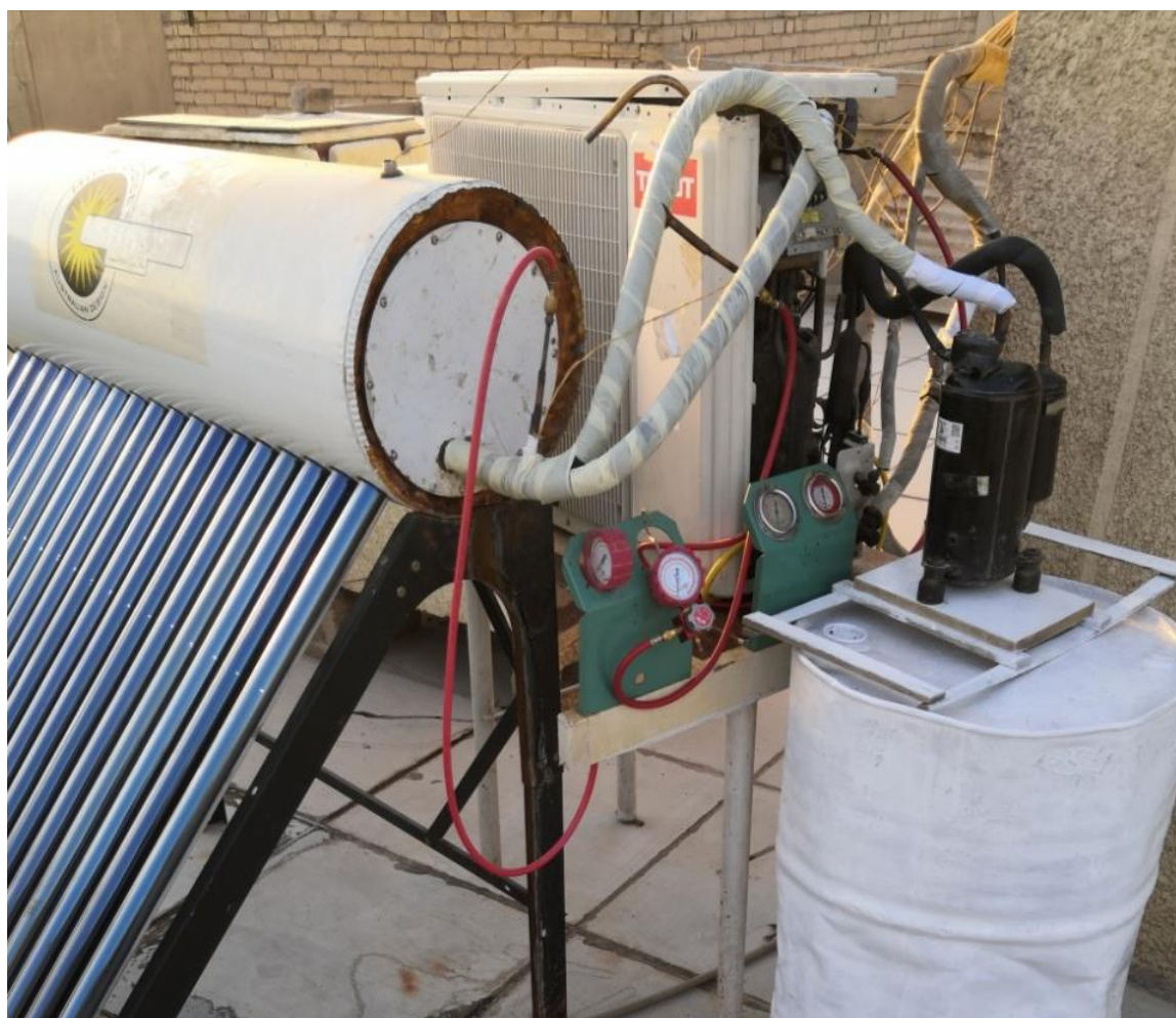
Рис. 3.6. Наружный блок и солнечный коллектор
