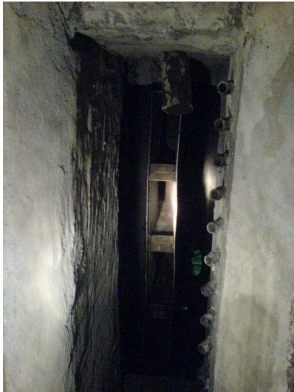
Рисунок 1.15 – Амбразура горелки котла БКЗ-210-140Ф
