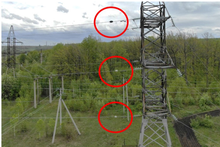
Рис. 12. Датчики модернизированной Системы, установленные на ЛЭП 35 кВ в ПАО «Татнефть»
