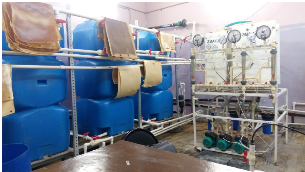
Рис. 5.3. Общий вид электромембранной установки утилизации продувочных вод ТЭК Казанской ТЭЦ-3.
