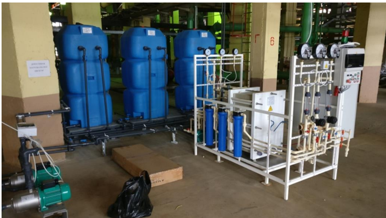
Рис. 5.9 Общий вид электромембранной установки в цехе ХВО-2 Нижнекамской ТЭЦ-1
