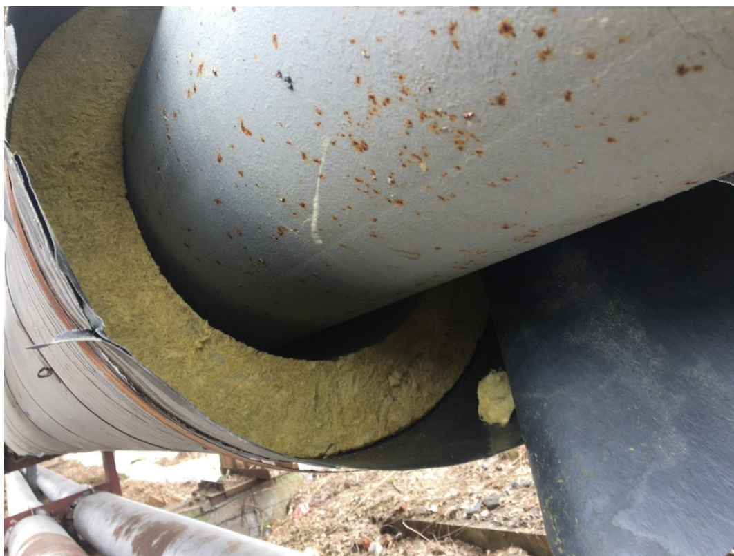
Рис. 1.2 Дефекты минераловатной изоляции
