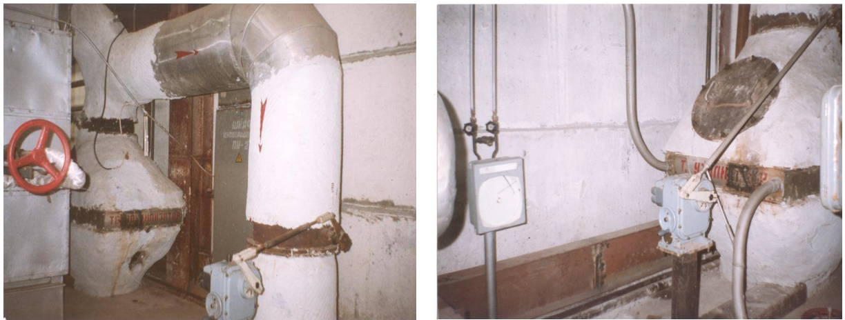
Рис. 2.1. Фотографии теплоутилизационной установки за котлом ДЕ-10-14 ГМ на Ульяновской ТЭЦ-3
